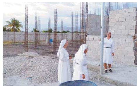
Les sœurs dominicaines qui vivent à Haïti et dirigeront la clinique inspectent le chantier
